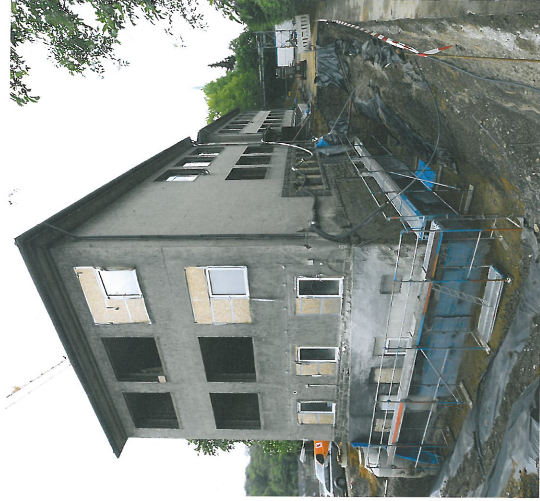
Für die Sanierung der Sockelfußpunkte der Dilldorfschule in Essen mussten die gesamten Außenwände – hier eine Teilfreilegung – zunächst bis auf 3,50 Meter Tiefe frei gelegt werden.
